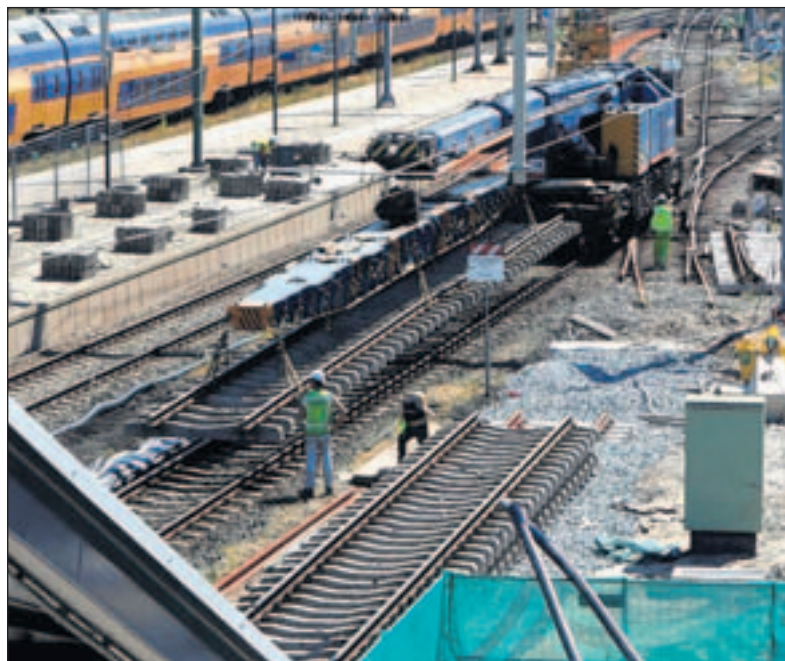
Op het Zwolse station worden onder meer nieuwe sporen aangelegd. foto Tom van Dijke
